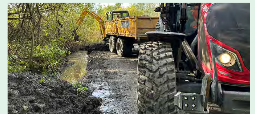
Kraftig redskap ble benyttet ved grøfting mellom Bekkasinmyra og Østensjøveien i nord.
