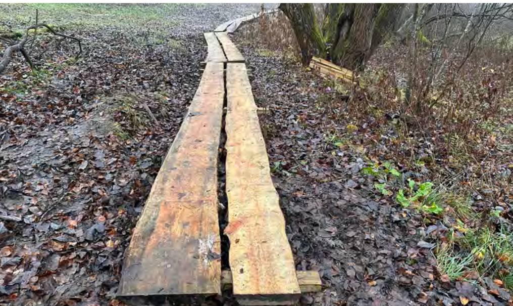
På nedsiden av Sjølienga mot Manglerudskogen er det ofte svært glatt og mye søle. Ødelagte klopper er fjernet og nye er lagt ut. Klopper hindrer også slitasje i området. Foto: Leif-Dan Birkemoe.
