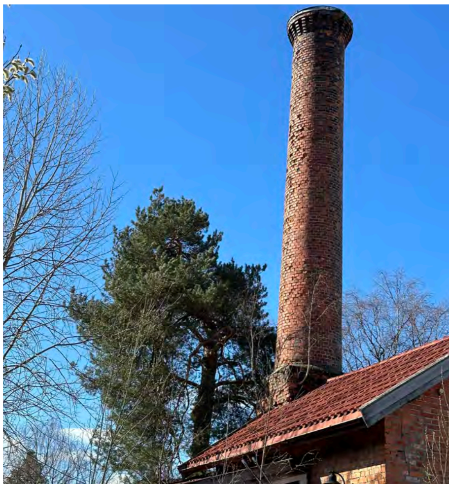
Skorsteinen på Eterfabrikken er i dårlig forfatning. Busker vokser ut fra fabrikkpipens fundament og mursteiner løsner. Foto: Leif-Dan Birkemoe, 18.04.2024.
